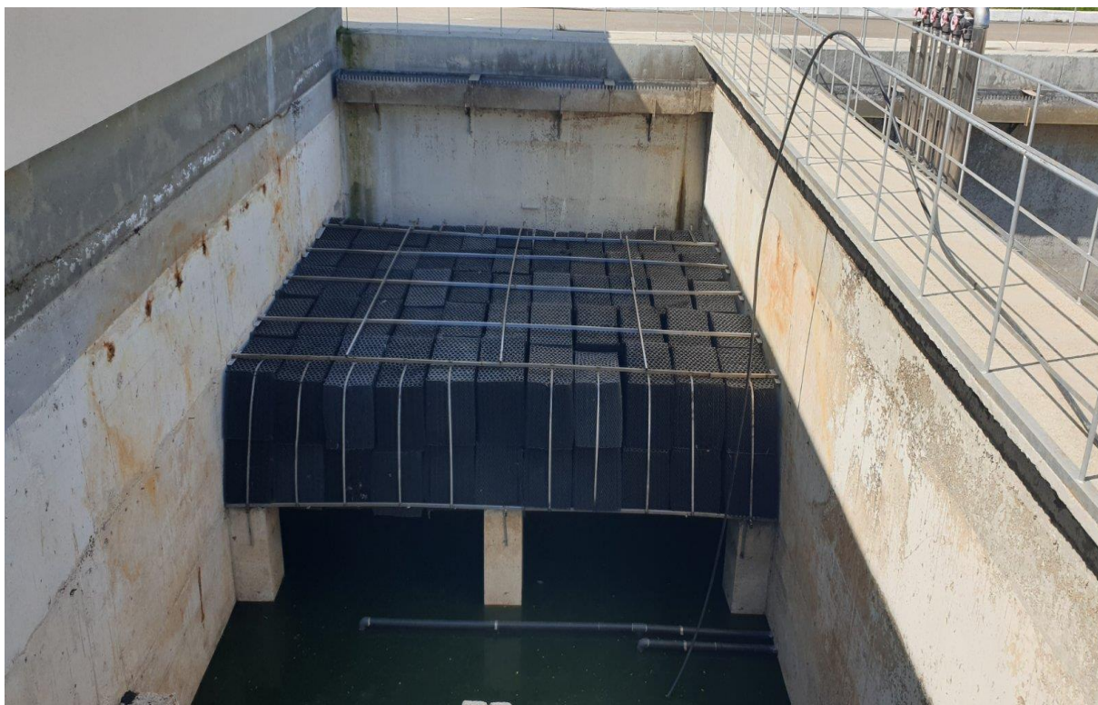
Figura 2.1 Unitate de biofiltru la stația de epurare a apelor uzate din orașul Căușeni (Republica Moldova)
